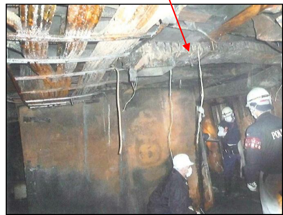
写真⑱ 冷凍機士のベッド上方
