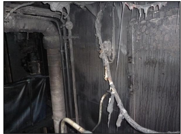
写真⑩ 機関室内の状況
