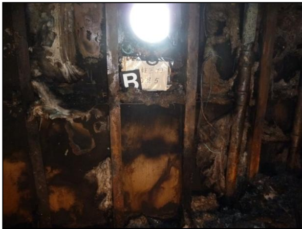
写真⑪ 左舷船首方の船室：焼損が激しい
