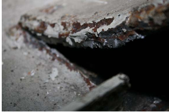
写真 2.5.4-4 溶接線の破断面
