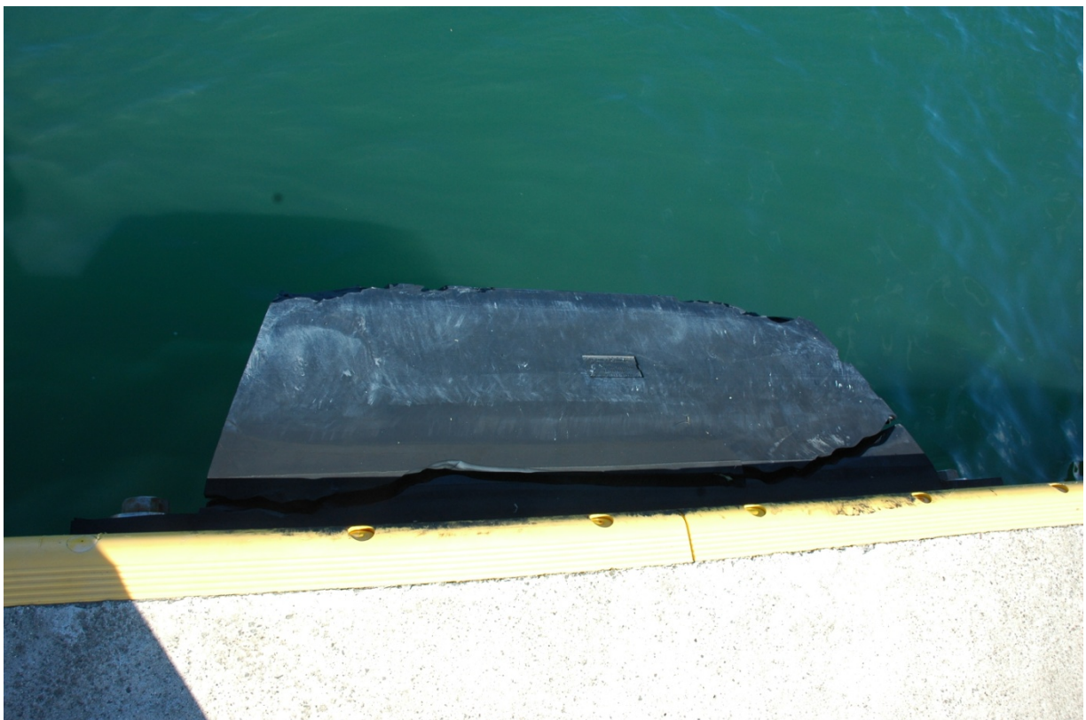
写真6 損傷したフェンダーの状況
