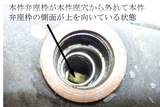
図9 本件弁座枠の状態
