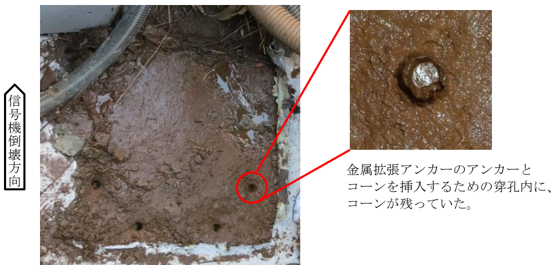
付図9 本件信号機柱が固定されたコンクリート躯体の表面及びコーンの状況
