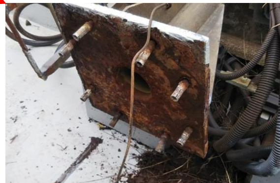
本件信号機柱の台座裏面の状況
