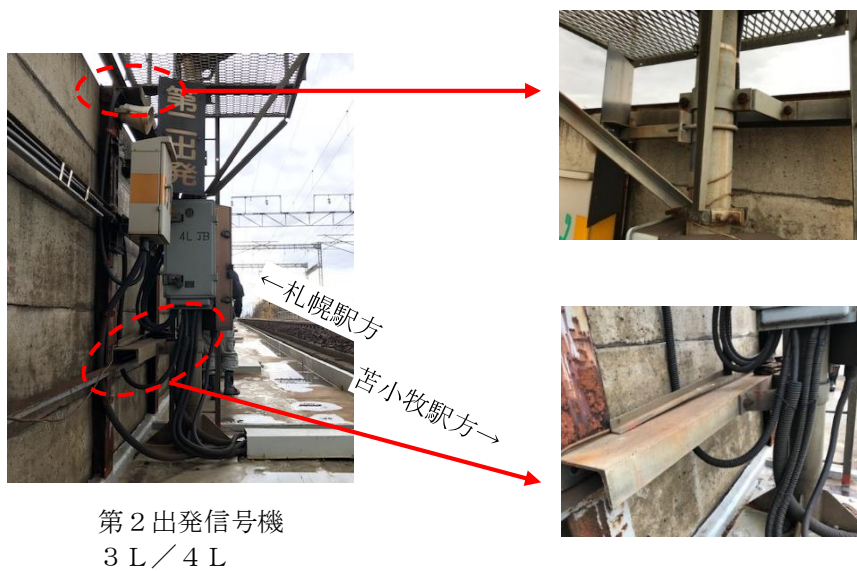
付図11 第2出発信号機3L/4Lの補強状況
