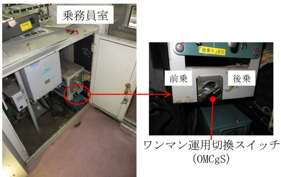
付図8 ワンマン運用切換スイッチの設置状態
