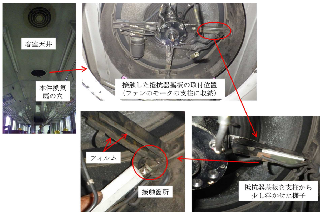
付図7 先頭車両の本件換気扇の状況
