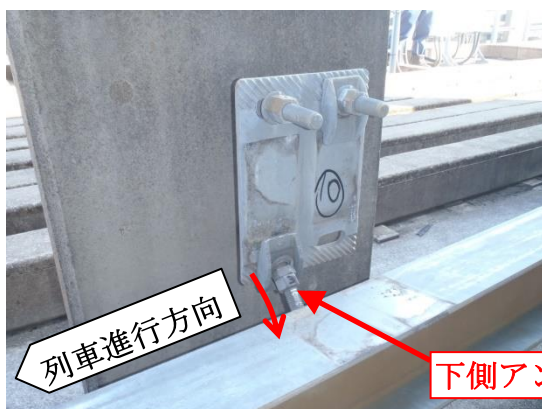
(a) 下向きに変形 (支柱⑩)
