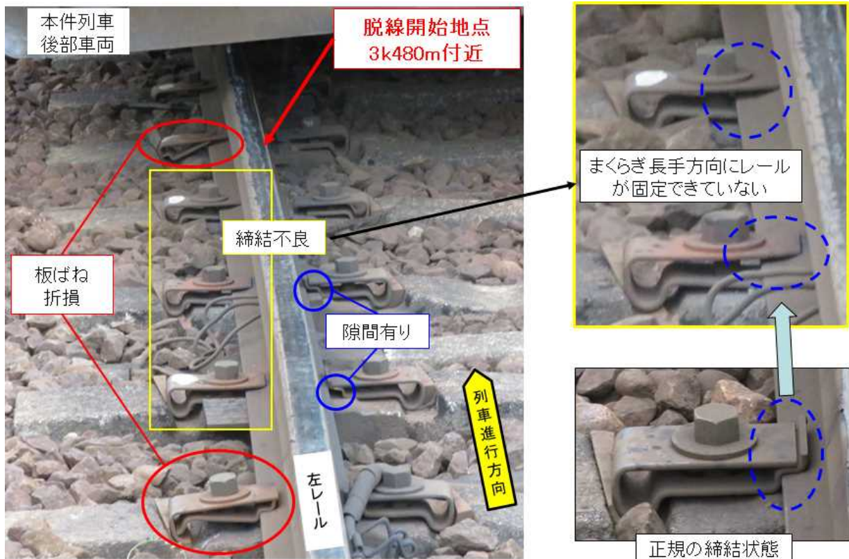
図3 レール締結装置の状態
