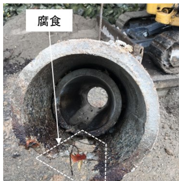
図7 鉄筋コンクリート管の破損断面 (鉄道側から山側を見た状況)
