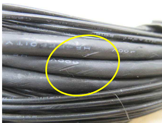
図10 他のケーブルの傷
