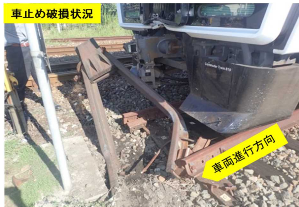
付図6 鉄道施設及び車両の主な損傷状況 (その1)
