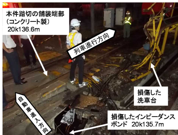
写真3 鉄道施設の主な損傷
