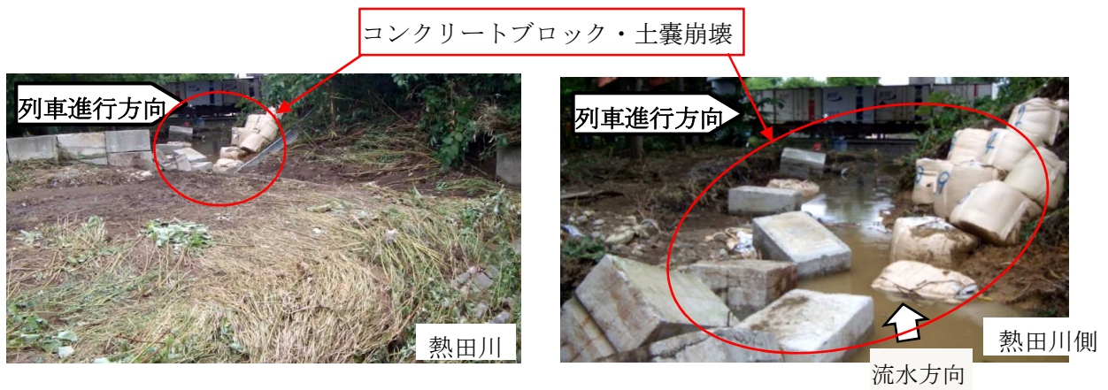
写真2 事故現場の状況（2）
