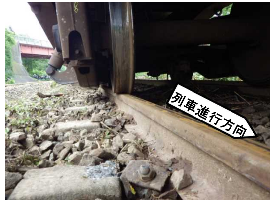
締結装置の損傷状況
