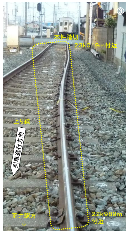
本件踏切から荒井駅方面に向け、上り線路左側へそれていく連続した痕跡
