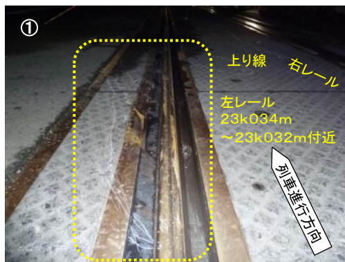
上り線左レール頭頂面から左側接続軌道面上にかけて何かを引きずったような痕跡
