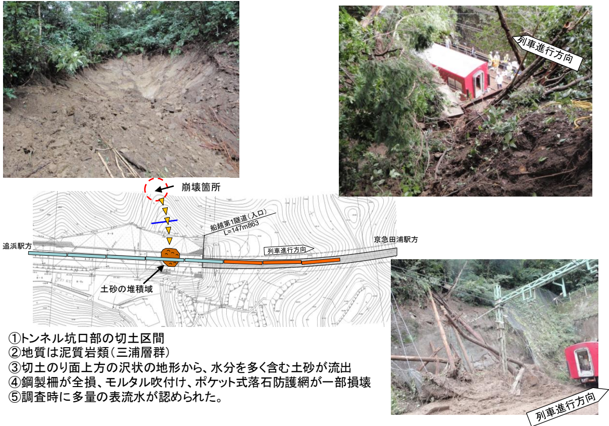
写真3 事故現場付近の状況（その3）
