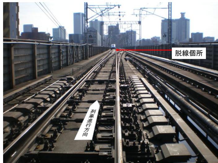
写真2 事故現場付近の状況（その1）
