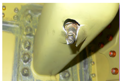
トラック・カン破孔部
