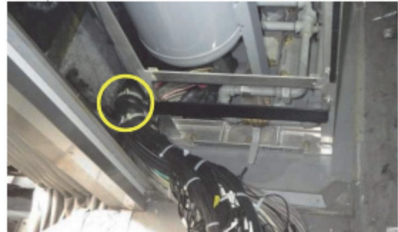
通路側から見た配線状況 (○印のケーブル束の裏側で断線)
