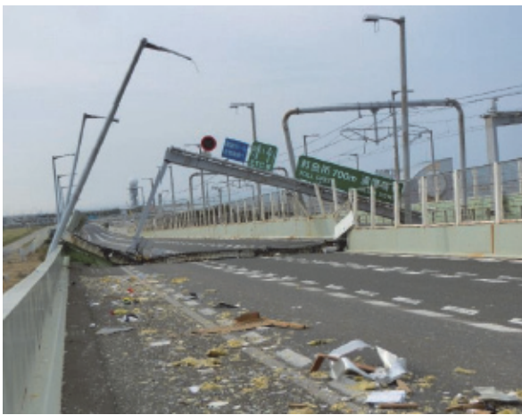
関西国際空港連絡橋の損傷状況
