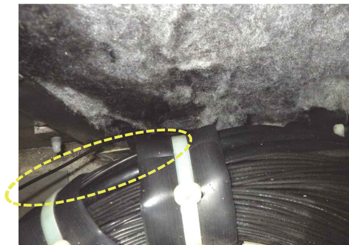
図2 F線がケーブルの束から外れている状況
