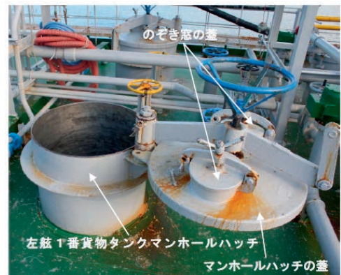
貨物タンクマンホールハッチ
