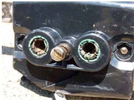
写真 2.12.7.3 J3ケーブルコネクタの損傷
