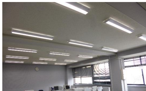
写真2 LED照明器具
