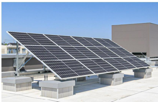
写真3 太陽光発電設備
