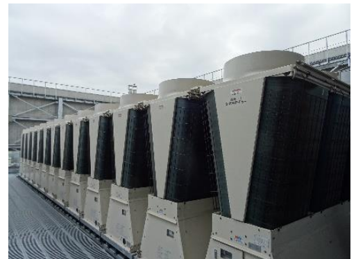
モジュールチラーの外観写真 (千葉市新庁舎)
