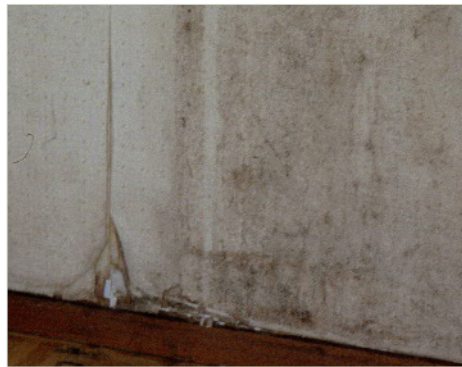
写真 4.1.2 カビによる汚損
