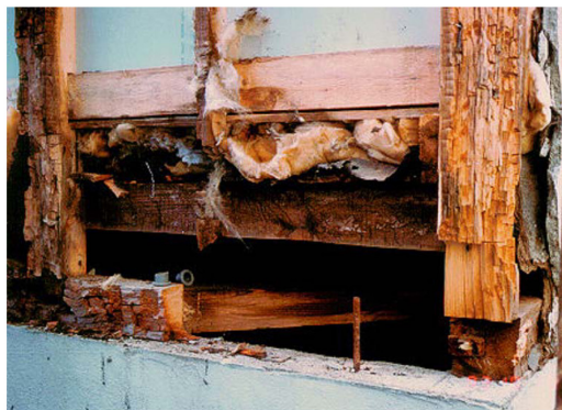
写真 3.2.3 内部結露による躯体の腐朽
