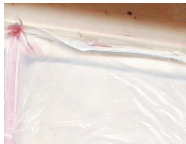
図 5.3.10 防湿フィルムの施工の悪い例 - 2
