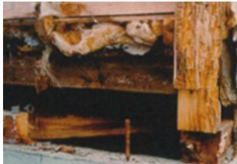
写真 4.1.3 結露による腐朽
