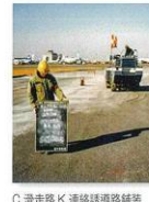
C滑走路K連絡誘導路舗装工事（新Aとの連絡誘導路）
