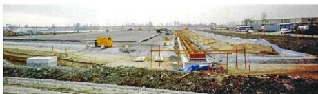
西側整備地区エアライン格納庫（まだ建築していない）前のエプロン建設現場（遠く奥に見えるのは、A-R/Wの進入灯橋梁、左が東京湾・湾側）
