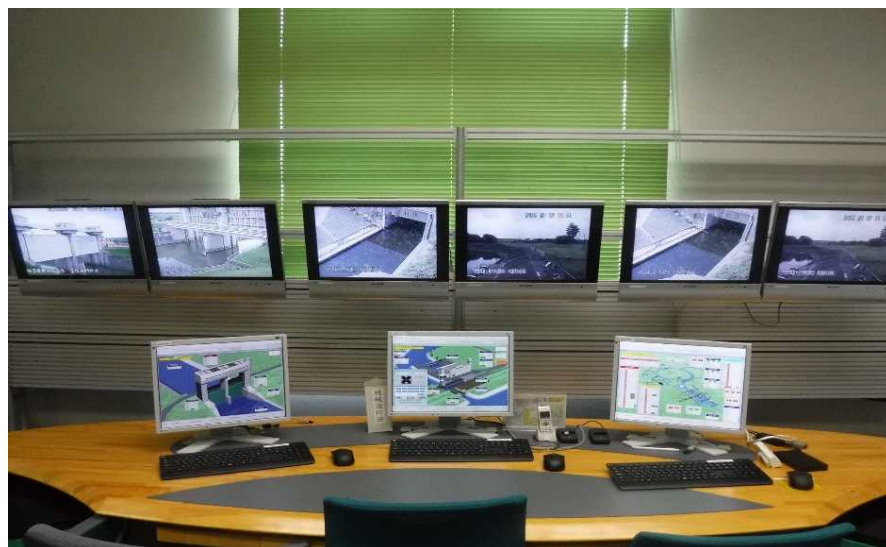
機械設備の遠隔監視・操作装置
