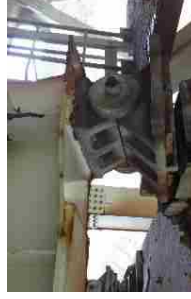
<橋梁の支承・主桁の損傷>
