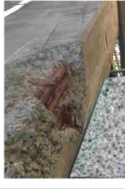
損傷状況（鉄筋露出）
