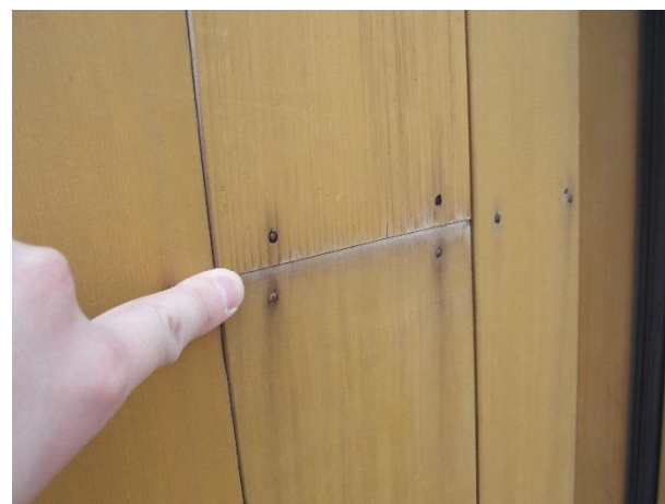
難燃処理薬剤の析出事例(白華現象) (左記の建築事例とは別件)
