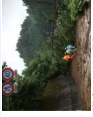
災害により通行できなくなった道路
