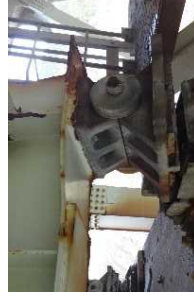
<橋梁の支承・主桁の損傷>
