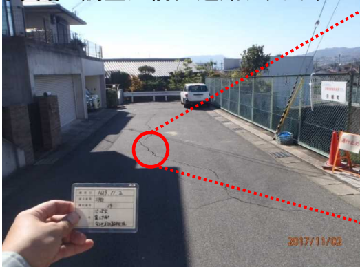
〔写真③ 調整池前面道路クラック〕
