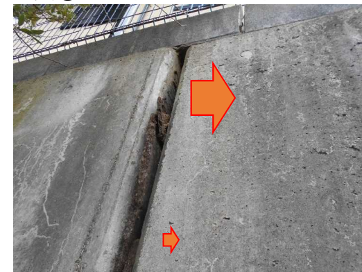
〔写真⑤ 調整池間知石のずれ〕
