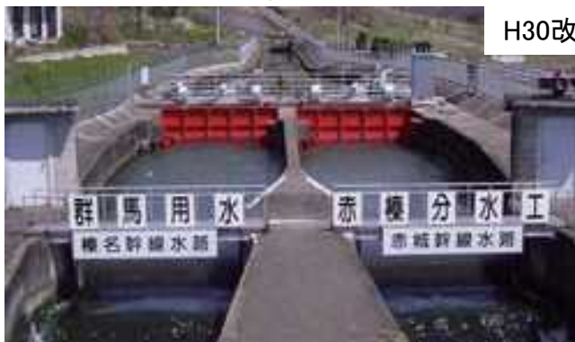
群馬用水施設(水資源機構) S44事業完了、H21改築
