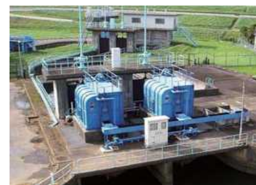
成田用水施設(水資源機構) S55事業完了
