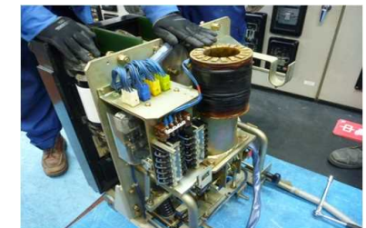
電気設備の焼損状況
