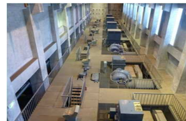
老朽化した横芝揚水機場
