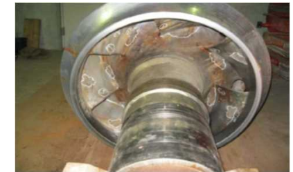
ポンプ羽根車の壊食状況
