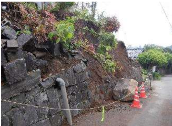
宅地空石積の崩壊
