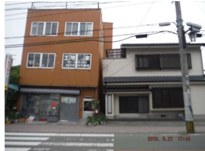
宅地地盤の沈下(家屋の傾斜)
