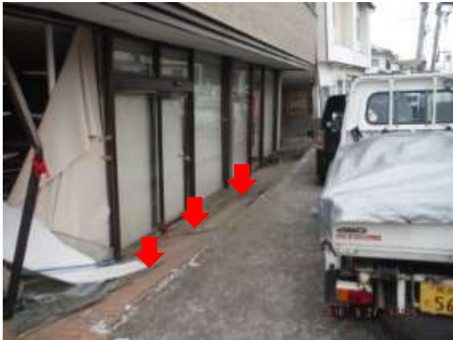
宅地地盤の沈下
