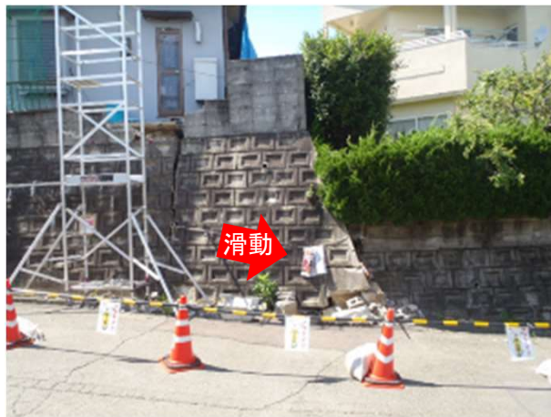
宅地擁壁の変状
