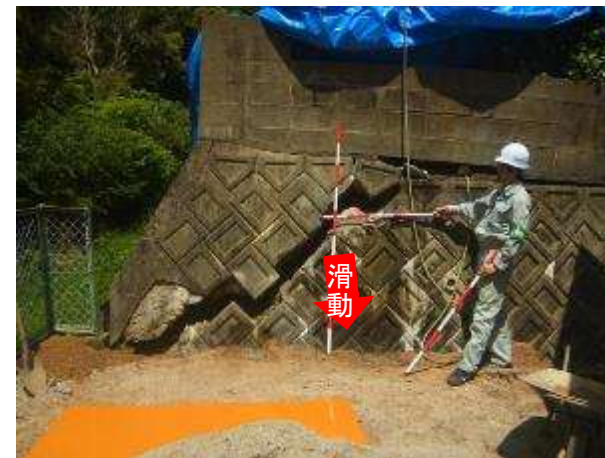
宅地擁壁の変状
