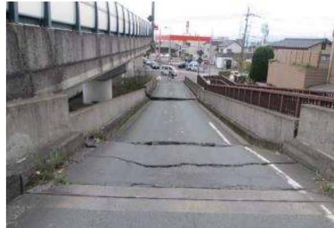
道路橋の亀裂
