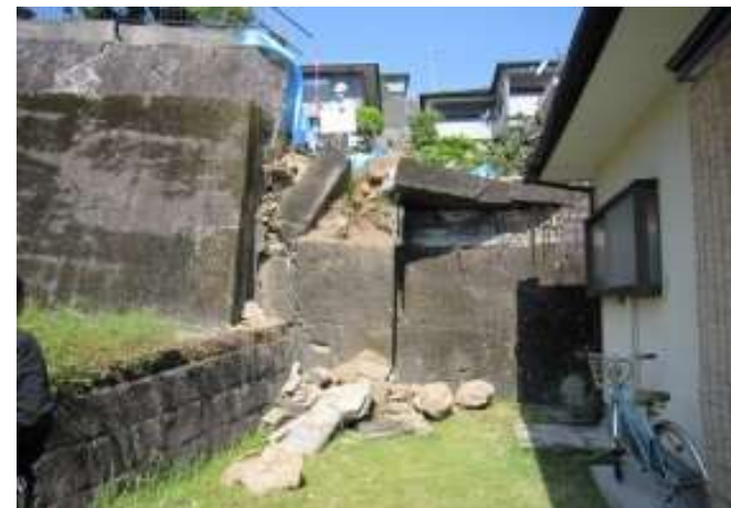
宅地擁壁の崩壊
