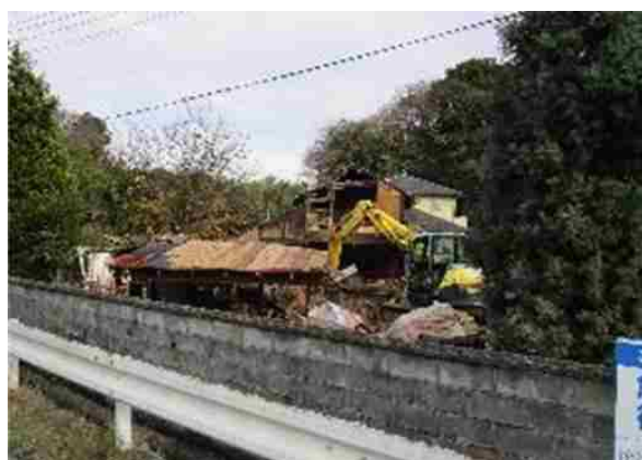
写真2: 屋根が崩壊した空き家(荒尾地区)
