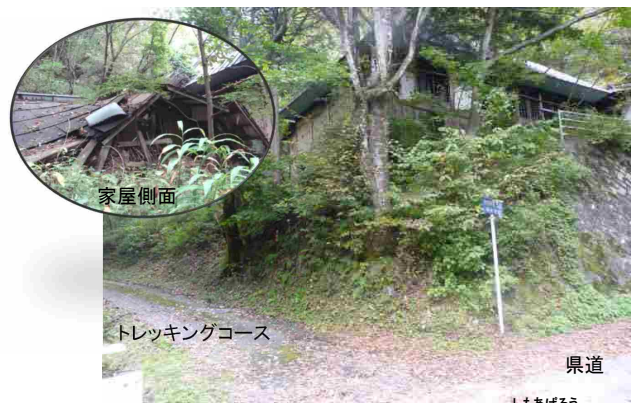
写真1: 道路に隣接する荒廃空き家(下上籠)
