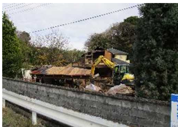
写真2: 屋根が崩壊した空き家(荒尾地区)
