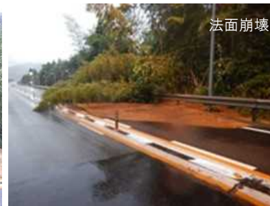
被災年月日:平成16年10月21日 通行止め:2日間
