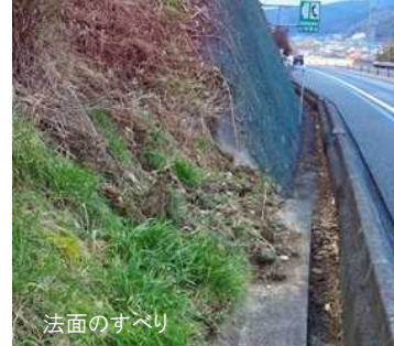
《法面危険箇所》
