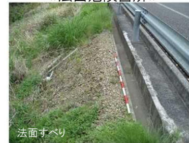
《法面危険箇所》
