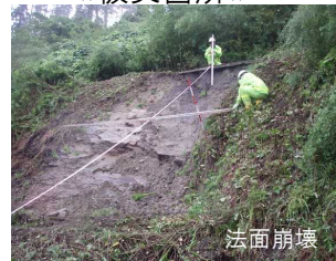
被災年月日:平成19年7月13日 通行止め:3日間
