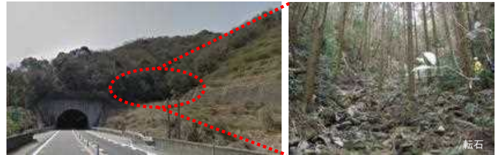
《法面危険箇所》
