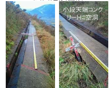
《法面危険箇所》
