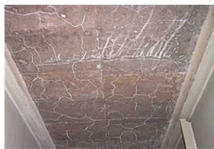
図1 床版の亀甲状ひび割れ
