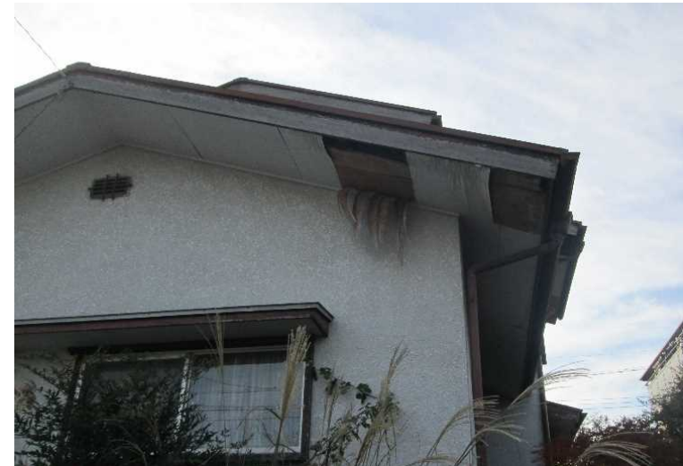
写真1: 軒裏からハクビシン等が進入している可能性がある。
