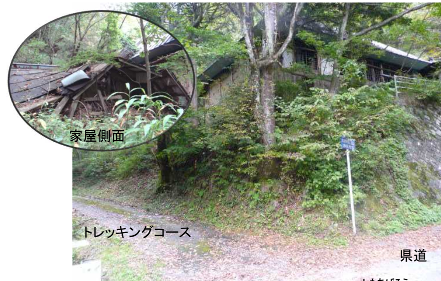
写真1:道路に隣接する荒廃空き家(下上籠)
