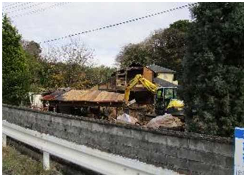
写真2:屋根が崩壊した空き家(荒尾地区)
