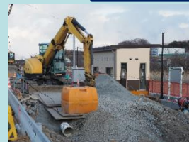
短大・団地が立地する八木沢地区に新設する「八木沢・宮古短大駅」
