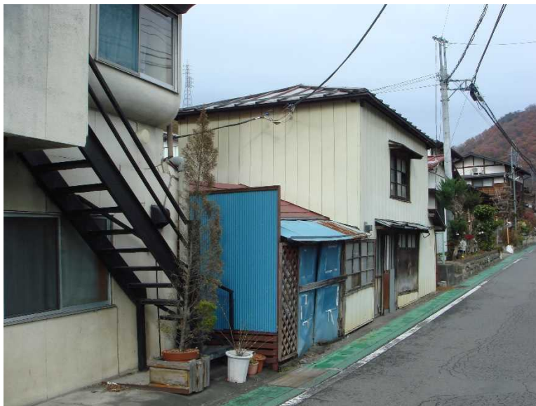
写真1:中心市街地の空き家(大月地区内) <窓の割れ、ベニヤ板での補強等あり>
