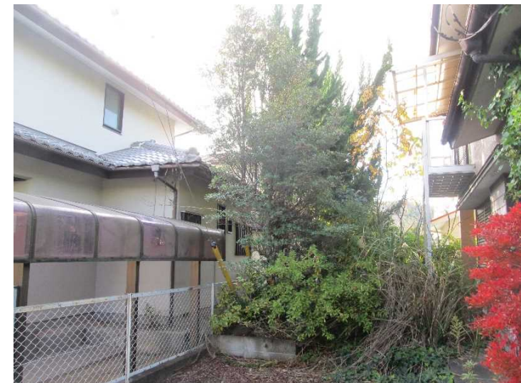
写真3:樹木の根が隣の家の配管に突き刺さり、支障を来している。
