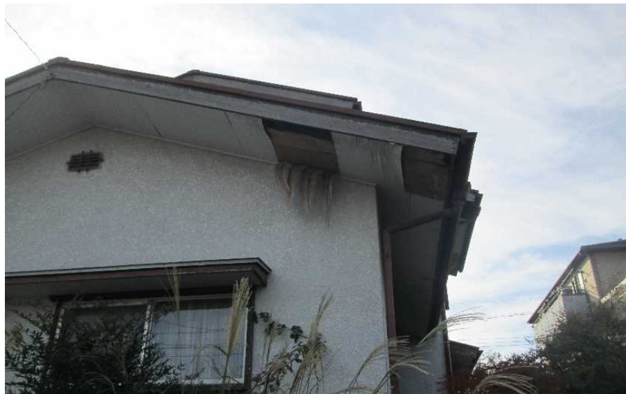
写真2:軒裏からハクビシン等が進入している可能性がある。
