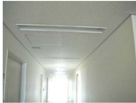
■不用照明の消灯（旅客ビル）
