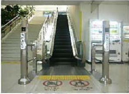
■エスカレーターの自動運転（旅客ビル）
