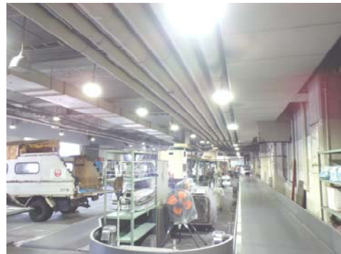
■荷捌場LED照明
