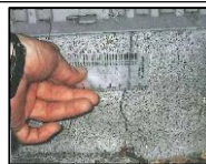
基礎のひび割れ幅の計測
