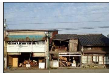
老朽化が進み 激しく損傷した家屋
