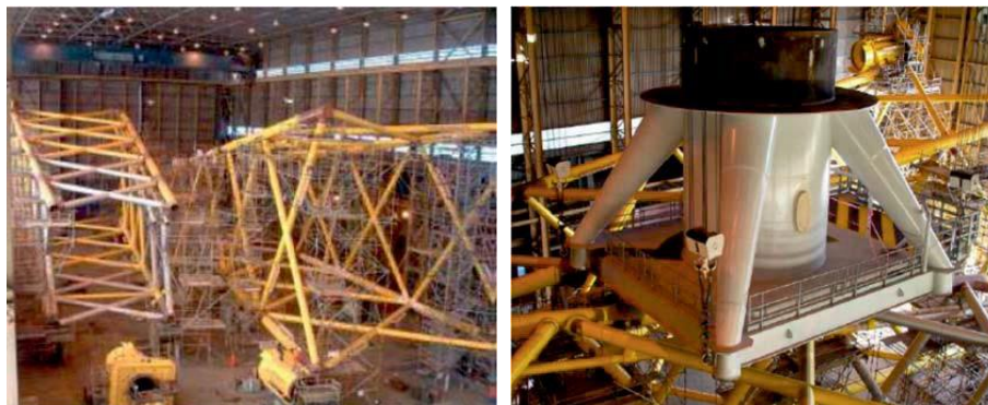
図 3.2.21 ジャケット (左) とトランジションピース (右) の製作状況 (出典 : Robertson J、2008)
