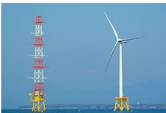
図 3.1.19 北九州市沖風力発電施設（ジャケツト式） （出典：NEDO、2014）
