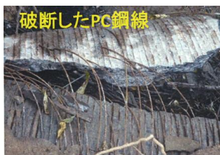
PC管の劣化状況
