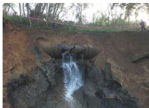
漏水事故の状況
