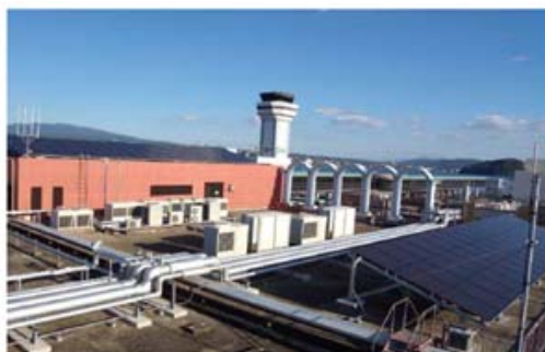
太陽光発電設備
