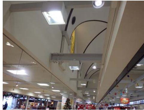
■旅客ビルテナント照明 LED
