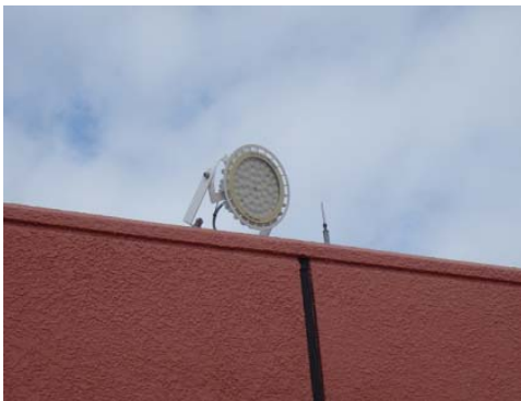
■旅客ビル屋上 LED 照明
