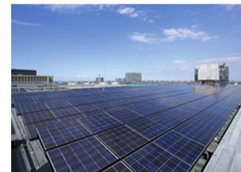
丸の内パークビルの屋上に設置した太陽光パネル
