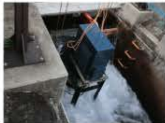
農業用水路を活用したマイクロ水力発電に取り組んでいる
