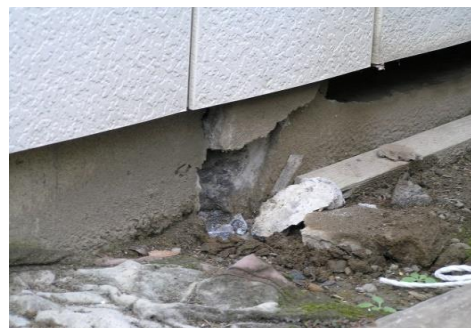
図2 地震時の開口部の被害
