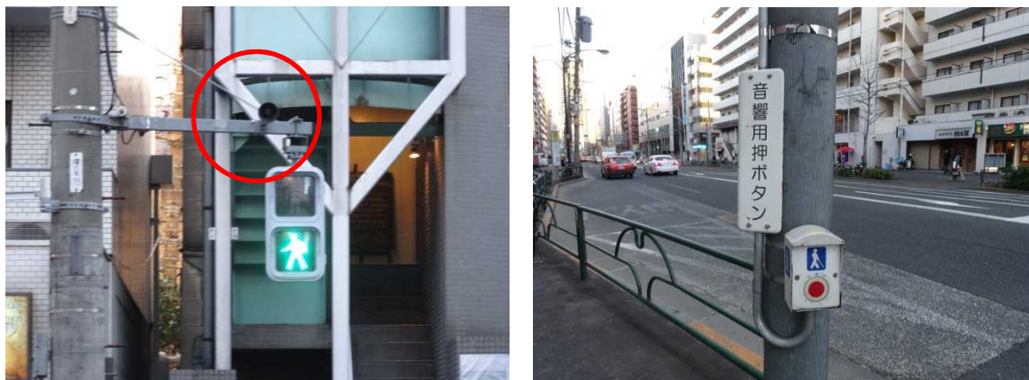
図3. 9 音響式歩行者用信号の例（左：音響スピーカー 右：音響用押しボタン）
