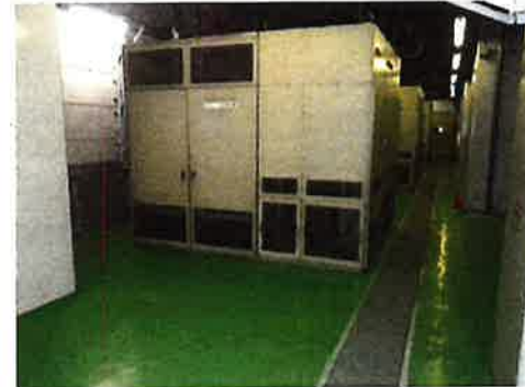
江坂変電所1号シリコン変圧整流装置更新
