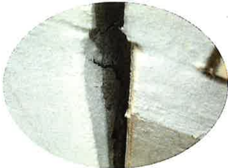
ブロック損傷状況
